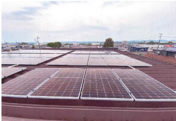
社屋の屋上に設置した太陽光発電設備
