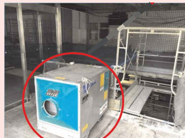
集塵機を設置し室内の換気を実施
