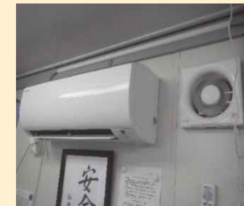
扇風機や換気扇とエアコンを併用
