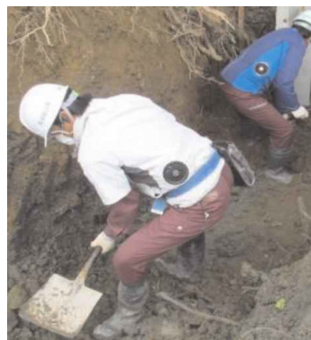
空調機能付きの作業服を活用
