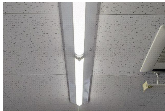
写真 執務室のLED照明
