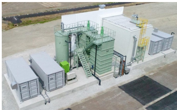
写真 高濃度メタン発酵処理装置
