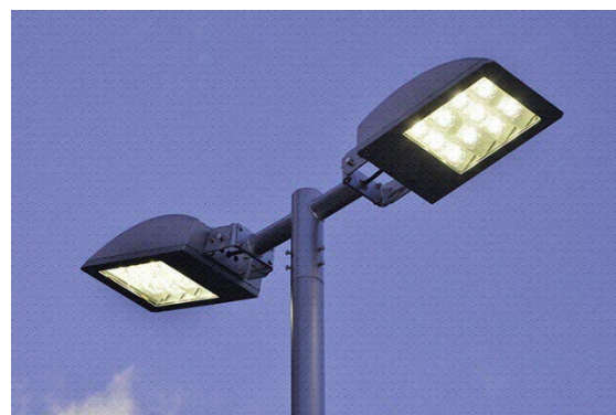
写真 LED 公衆街路灯
