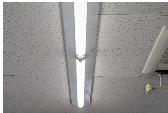
写真 執務室のLED照明
