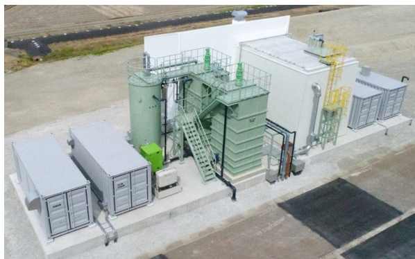
写真 高濃度メタン発酵処理装置
