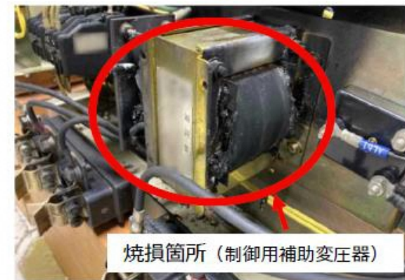
<取り出した制御機器>
