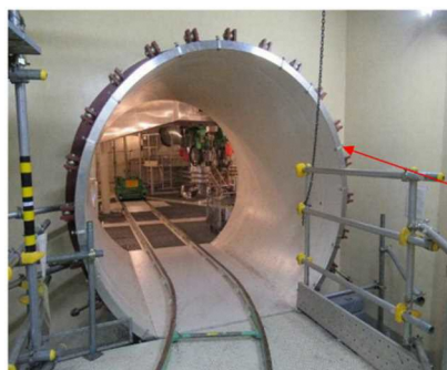
①上部D/W機器搬入用ハッチ
