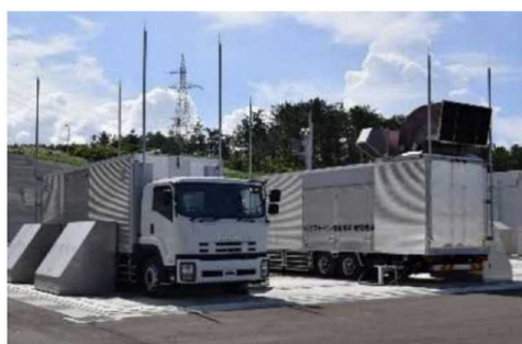
ガスタービン発電機
