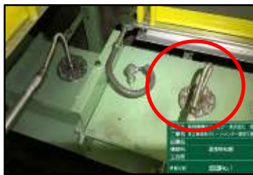
温度センサーを4台追加 広範囲と局部的に温度上昇を検知。（発生防止強化）
