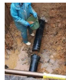
離脱した水道管 (七尾市)
